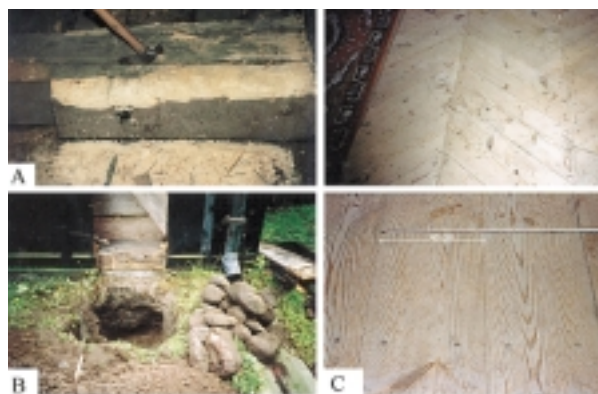
Ryc. 6. Kościoły drewniane. Metoda „badań architektonicznych” (A, B). Zabytkowa podłoga w jodełkę w dobrym stanie. Zalecenia autora badań: Podłogę z desek szer. 43-46 cm wymienić na nową z desek o szer. 27 cm
