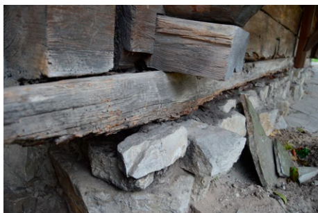
Ryc. 5. Stan fundamentów cerkwi Świętej Trójcy w Żółkwi, 2018; fot. T. Iwanyszyn, W. Herycz
